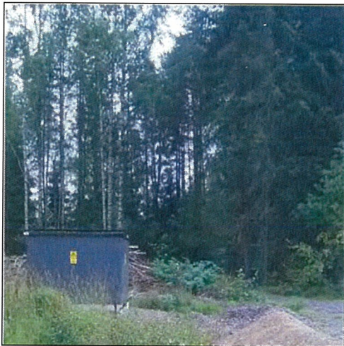
Rakennettu puistomuuntamo Juuriniemessä
