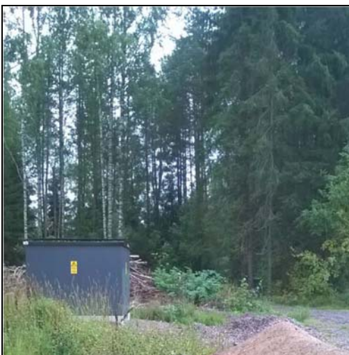
Rakennettu puistomuuntamo Juuriniemessä
