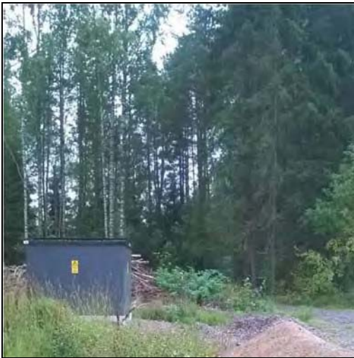
Rakennettu puistomuuntamo Juuriniemessä
